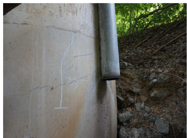
교각 균열(0.3mm미만) P3
