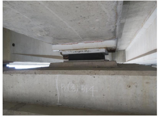
받침 콘크리트 균열(0.3mm미만) P2 A2-SH4
