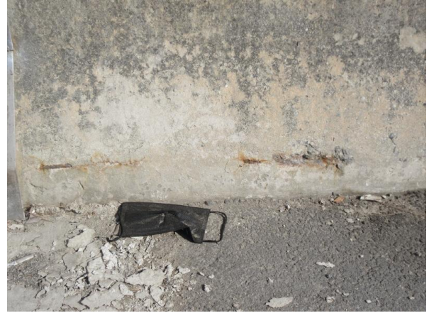
방호벽 철근노출 S4
