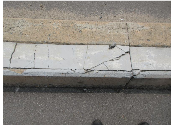
중앙분리대 보수부 표면박리 S4
