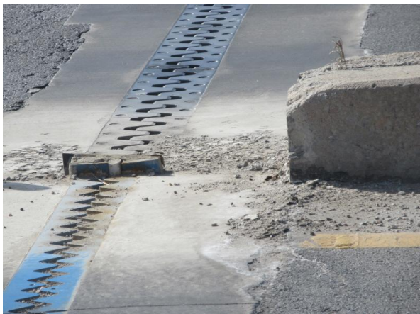
중앙분리대 상행 박락 S1
