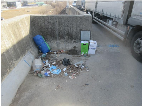
교면포장 이물질 퇴적 S3
