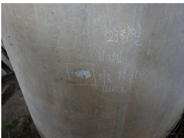
교각 파손 P3
