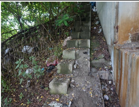
점검계단 파손 A1
