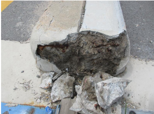
중앙분리대 상행 박락 및 철근노출 S4
