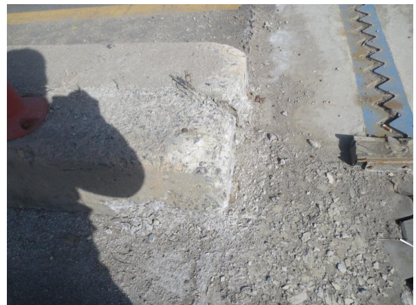
중앙분리대 하행 박락 S1
