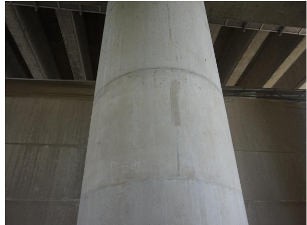
교각 망상균열 P1
