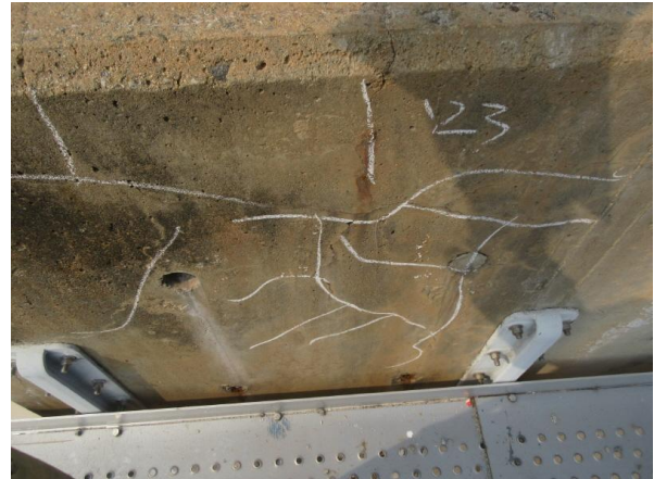
교각 망상균열 P2
