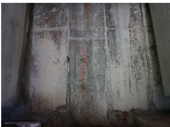
교대 균열(0.3mm이상) A1
