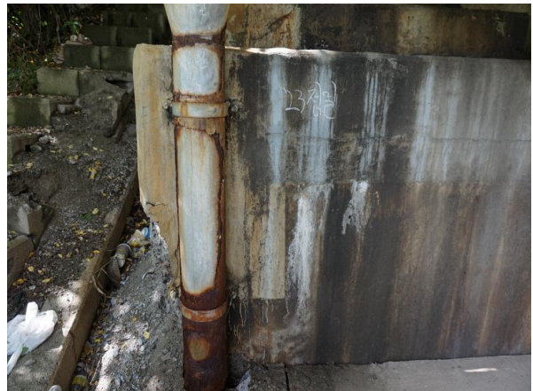
교대 박락 및 철근노출 A1(하절기)
