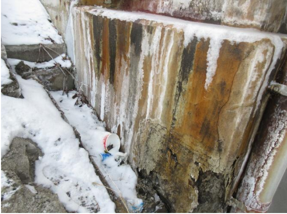
교대 박락 및 철근노출 A1(동절기)
