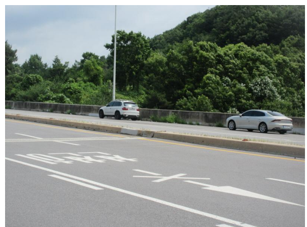
중앙분리대 차선 규제봉 탈락 S2~3
