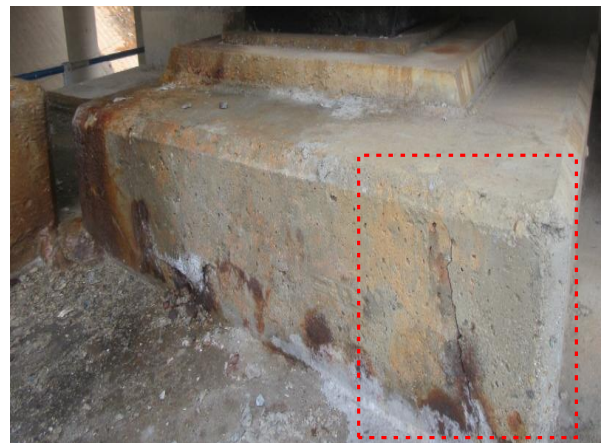
받침콘크리트 박리 P2 A1-SH6
