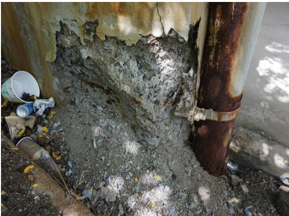
교대 박락 및 철근노출 A1(하절기)
