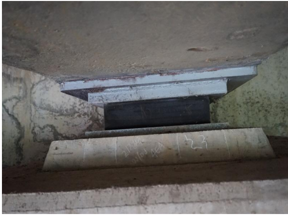
받침몰탈 균열(0.3mm미만) A2 SH2
